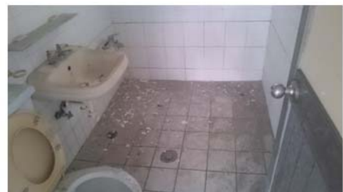
廁所老舊破損
