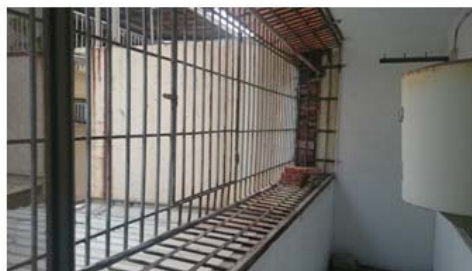
既有鐵窗老舊生鏽
