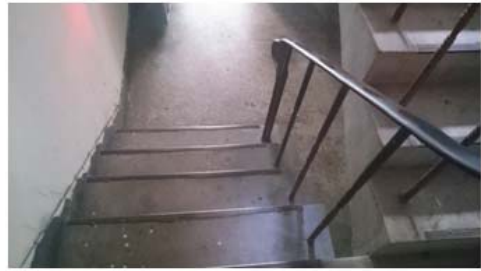
公共梯間扶手生鏽 止滑銅條破損
